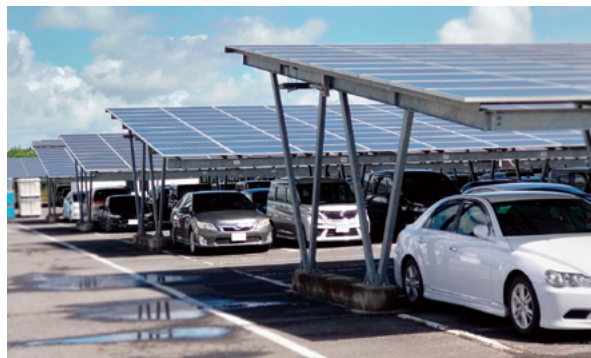
工場の駐車場に庇を兼ねたソーラーパネルを設置、PV 発電電力の自家消費と舗装の温度上昇を低減
